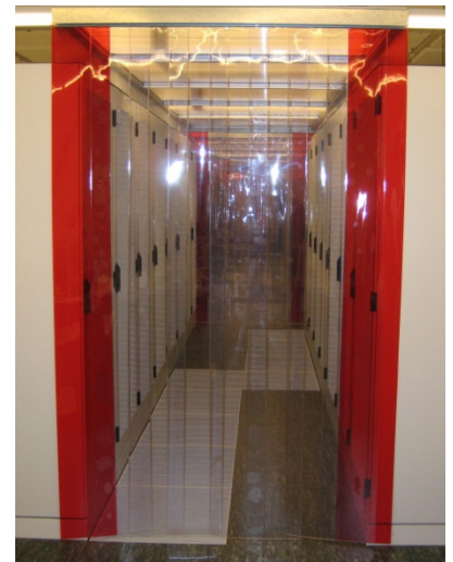
Kaltgangeinhausung für Racks. Die Bodenplatten sind vor den Racks mit Gitterplatten zu ersetzen
